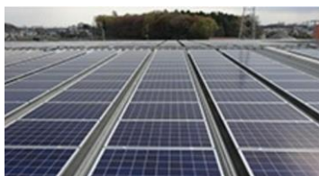
ユニクス伊奈 (発電容量：334.53kW)
