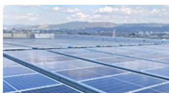
天理配送センター (発電容量：100.00kW)
