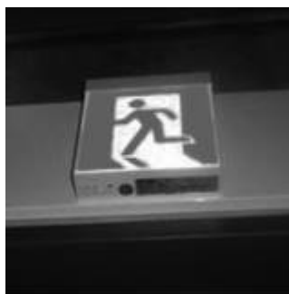
非常用誘導灯
